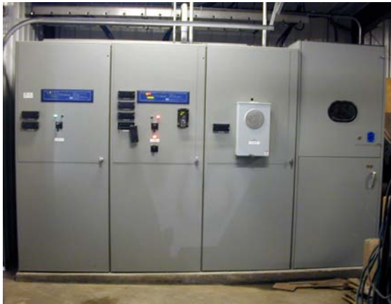
Figure 3—Entre as principais preocupações relacionadas à integração do gerador Peter Brotherhood com o resto do sistema WTE estavam os aspectos de proteção, monitoração e interfaces. Os Relés de Geradores SEL-300G foram adquiridos para fornecer a proteção necessária para o gerador restaurado.
