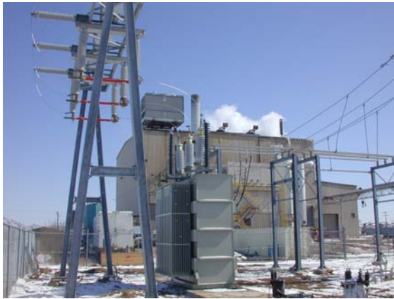
Figure 1—Em agosto de 2002, no seu segundo projeto de WTE, a Barlow efetuou a conversão de uma instalação de incineração de lixo existente em Perham, Minnesota, para uma usina de produção de eletricidade e vapor baseada na tecnologia Airedale da Barlow.
